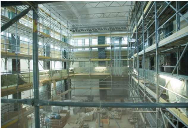
KWB IM STADTPALAIS, KÖLN – INNENAUFNAHME Der Scan muss vor Einrüstung des Objekts stattfinden, um benötigte Details erfassen zu können.
